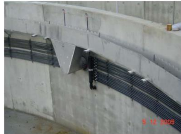
Wärmetauscher im Nachklärbecken
